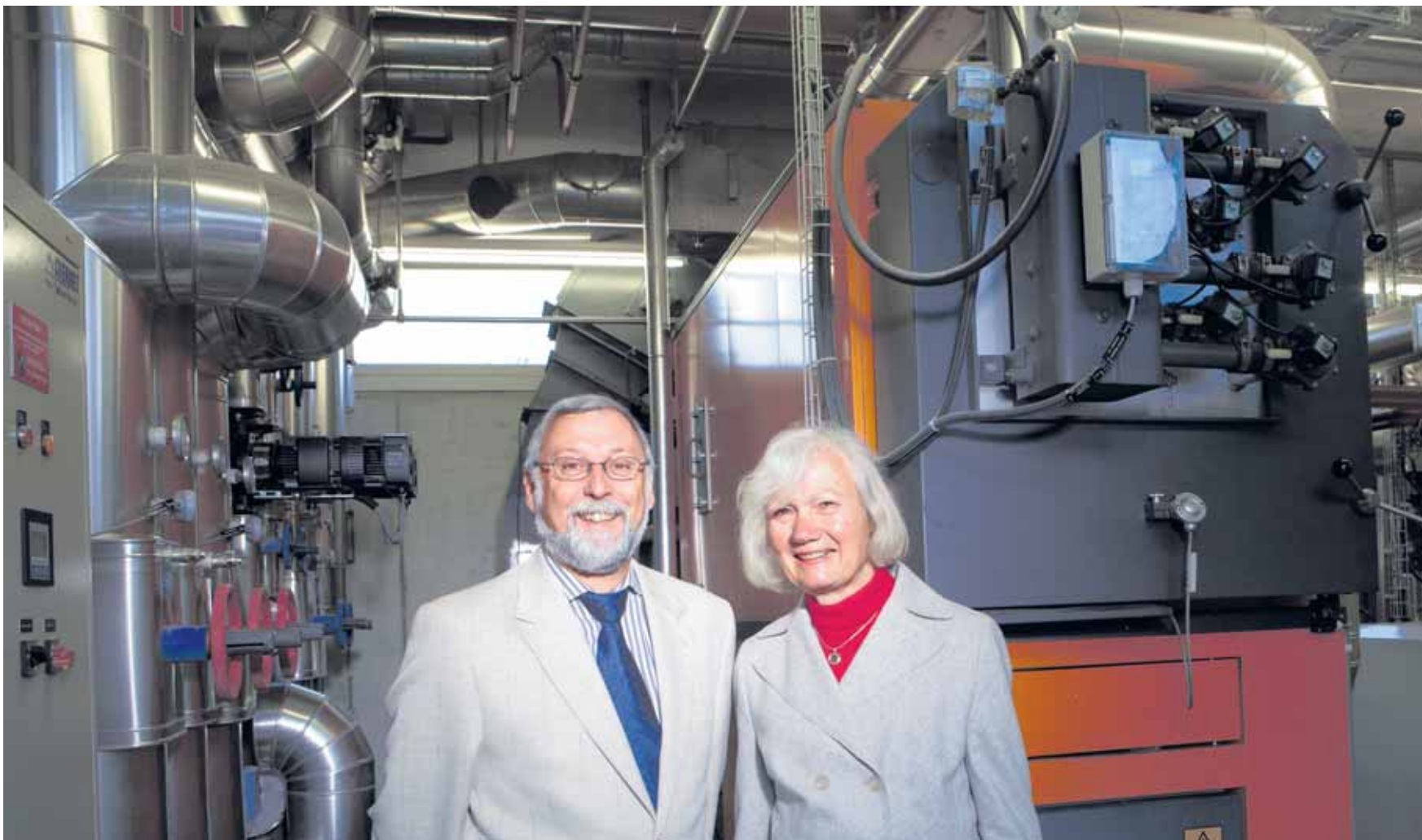
Il sindaco Jean-Pierre Helbling e la municipale Anneliese Meyer davanti alla centrale termica a cippato situata in un annesso della scuola Marly-Cité provvisto del certificato Minergie. (Foto: Regula Roost)
