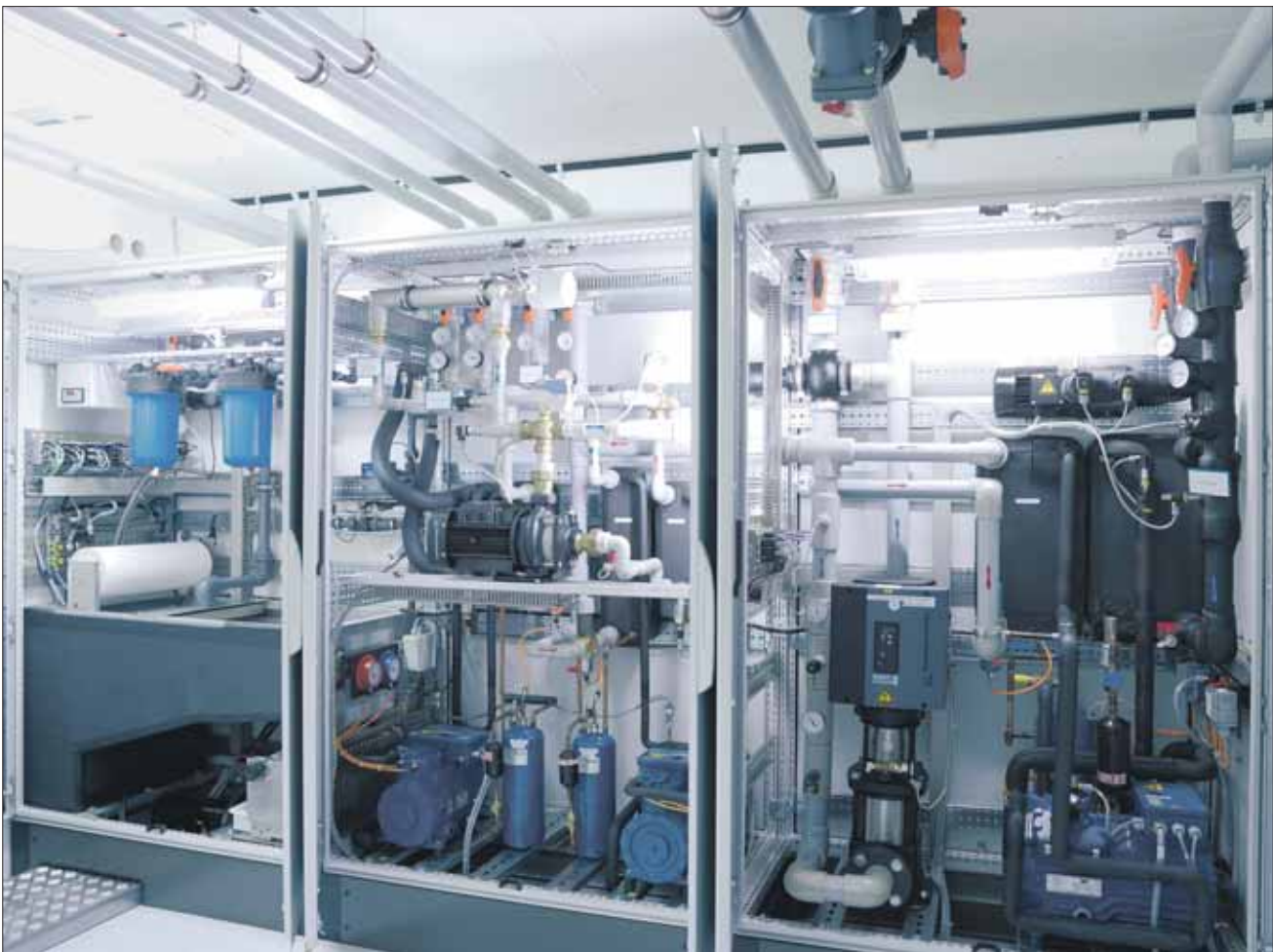
L'impianto EPMS provvede alla depurazione dell'acqua, alla regolazione della temperatura dei cilindri di stampa e alla produzione del freddo per la climatizzazione.
