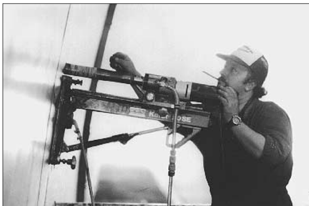
Figure 1.11 Une inspection permet de découvrir les dégâts à temps
