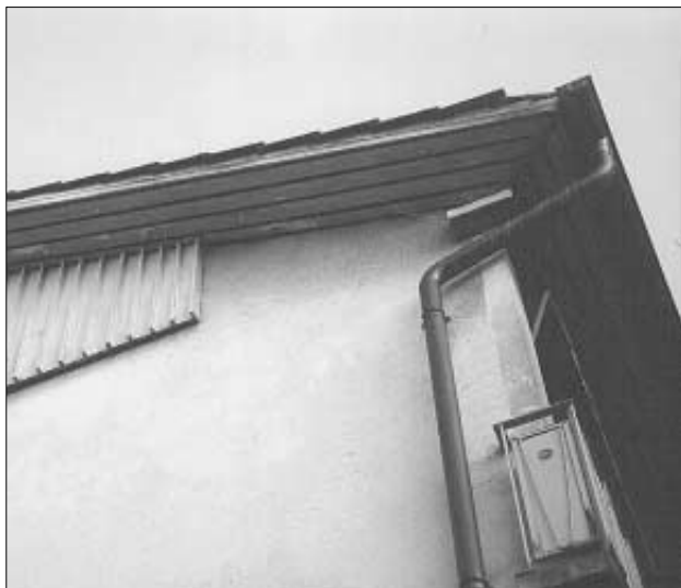
Photo 5.25 0.8 dégradation légère Chéneau légèrement déformé, eau stagnante, peinture écaillée, traces de corrosion
