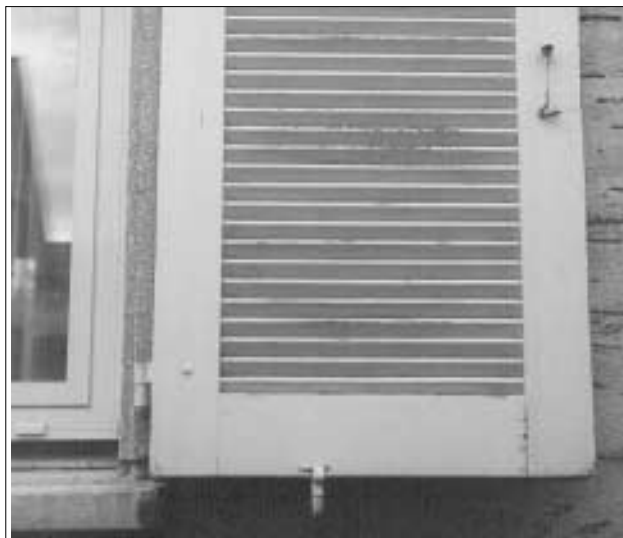
Photo 5.33 0.8 dégradation légère Premières traces de dégradation, les jointures de cadres se marquent
