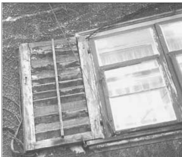
Photo 5.35 0.2 dégradation importante Dégradation avancée, la pourriture s'installe, ferments disparus, rouille, capacité réduite de fonctionnement (fermeture difficile, affaissement des cadres, etc.)
