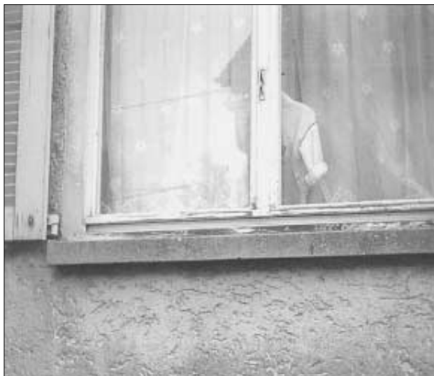
Photo 5.5 0.8 dégradation légère Angles endommagés, joints délavés, petites fissures
