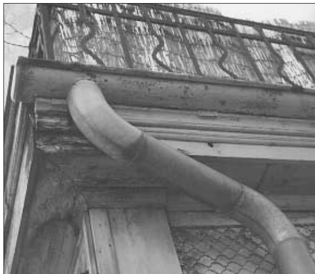
Photo 5.26 0.5 dégradation moyenne Peinture dégradée, traces évidentes de rouille, raccords ouverts, fixation lâche
