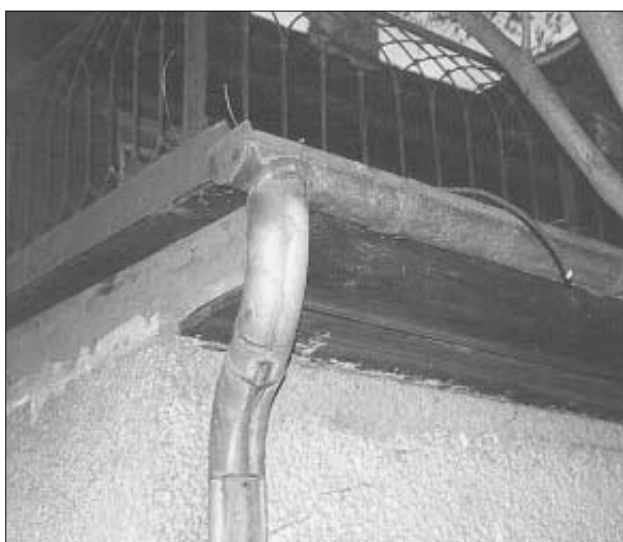
Photo 5.27 0.2 dégradation importante Tronçons complètement rouillés, tuyaux de descente non étanches, fixation défectueuse, chéneaux passablement déformés
