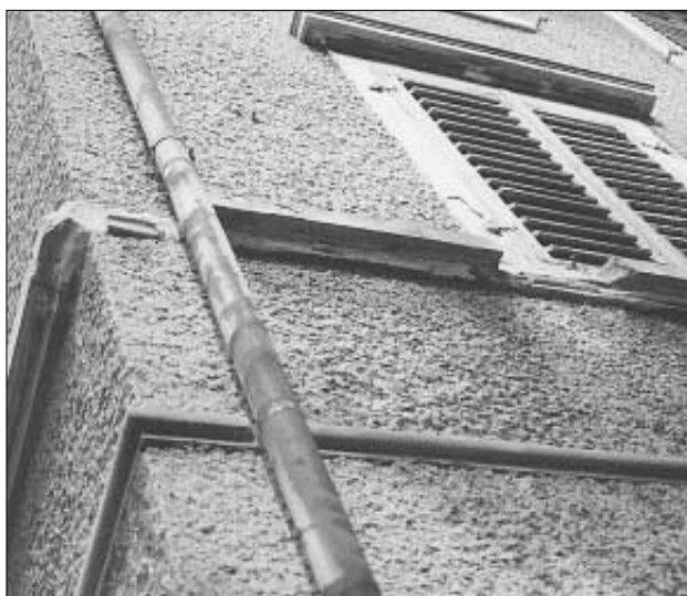
Photo 5.7 0.2 dégradation importante Lézardes, parties tombées, d'autres déplacées, joints ouverts, érosion avancée des matériaux sous l'effet des conditions atmosphériques
