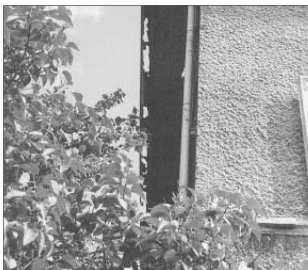
Photo 5.28 0.0 irréparable Chéneaux et tuyaux de descente ont des fuites
