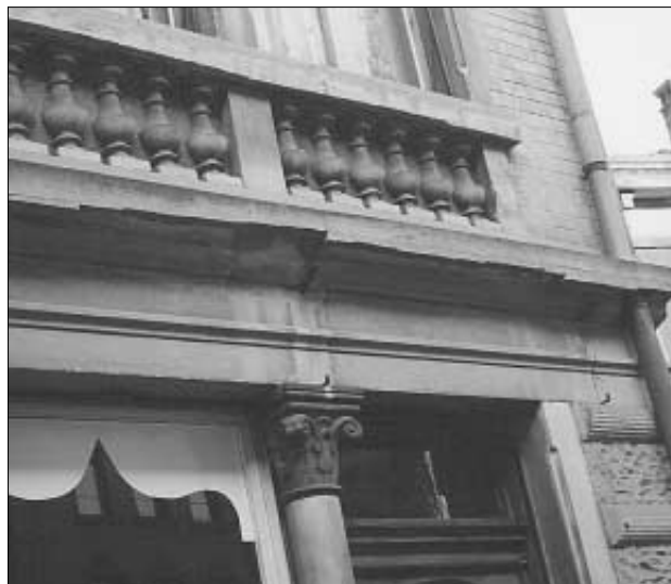
Photo 5.6 0.5 dégradation moyenne Angles ébréchés, parties de surfaces détachées, tailles rongées, début d'érosion des matériaux
