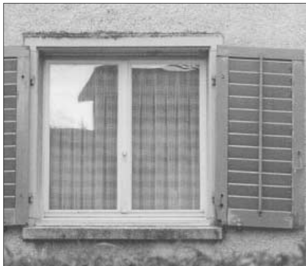
Photo 5.34 0.5 dégradation moyenne La couleur se défraîchit, les jointures des cadres se distendent, premiers signes de déformation Début de rouille sur les ferments
