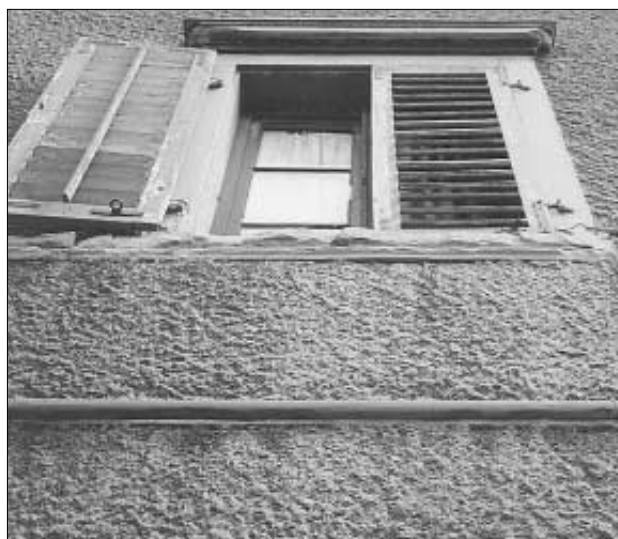
Photo 5.8 0.0 irréparable Des morceaux tombent, des éléments manquent; surfaces complètement lessivées
