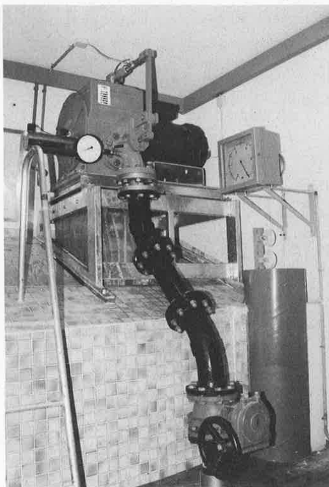
Standardisierte Installation einer Trinkwasserturbine von 25 kW Leistung in der Wasserversorgung der Gemeinde Fuldera. 20% des Gesamtenergieverbrauches der Gemeinde können damit gedeckt werden.
