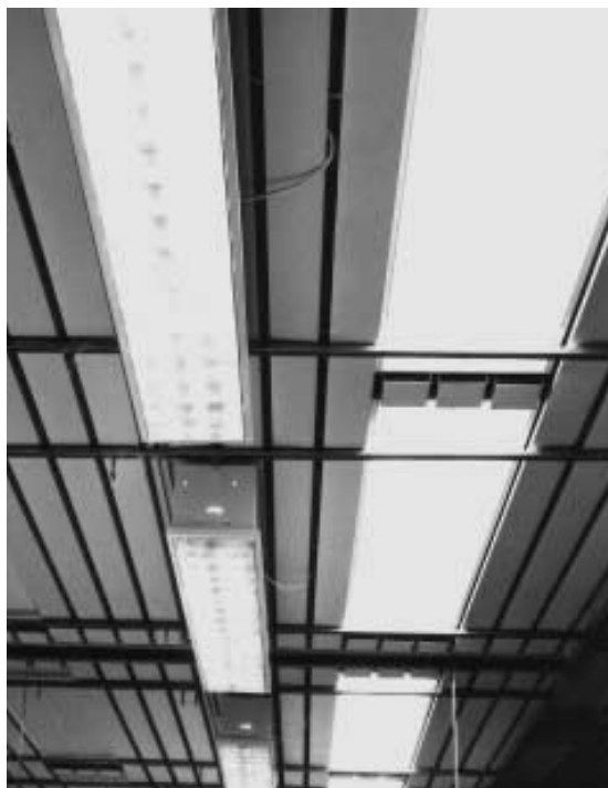
Figure 1.8: Comparaison d'un luminaire spécial pour postes de travail à écran (BAP, «dark light») avec un luminaire à grille conventionnel. La luminance du second est excessive.
