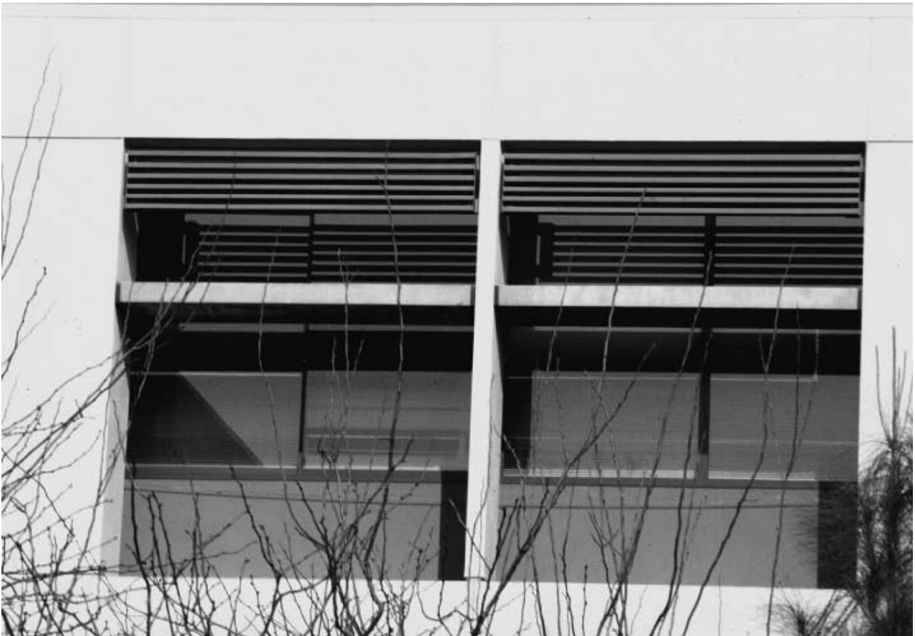
Figure 2.16: Exemple de bandeau lumineux (bâtiment de l'Etat de Californie, Sacramento, USA).
