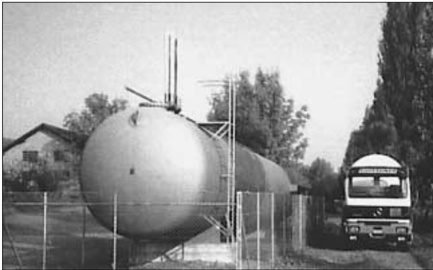
Figure 31: Exemple d'un approvisionnement au gaz propane à l'air libre (Photo: Basler + Hofmann AG).
