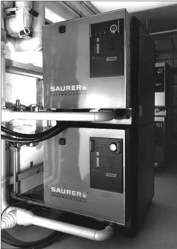
Figure 22: Quatre petites installations de couplage chaleur-force avec une puissance électrique de 4 X 15 kW donnent ensemble une puissance de chauffage de 156 kW.
