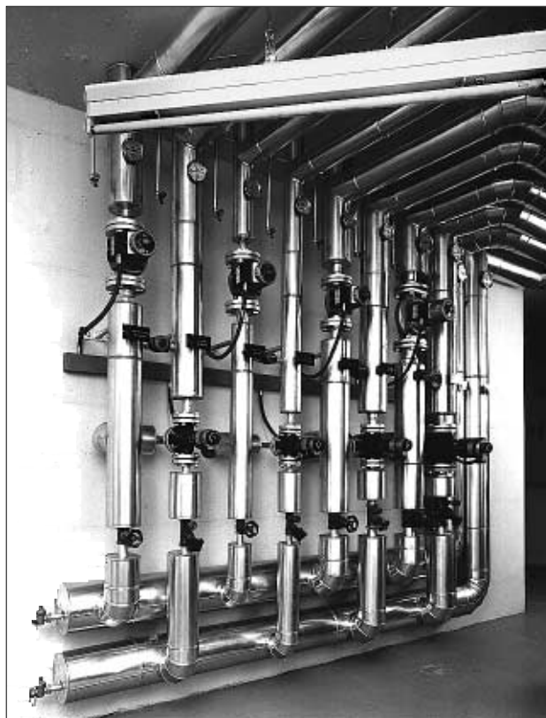
Figure 51: L'intégration d'installations d'un niveau énergétique élevé dans des systèmes existants pose problème. On dispose par exemple souvent de distributeurs à injection équipés de vannes à trois voies qui provoquent un trop fort mélange du retour. Dans ce cas, une seule solution s'impose : installer des vannes de passage !
