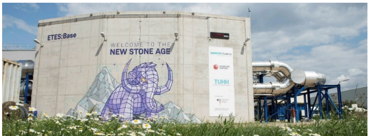
Figure 31: Installation pilote d'une batterie Carnot dans le nord de l'Allemagne (source: Siemens Gamesa) ( https://www.siemens-gamesa.com/products-and-services/hybrid-and-storage/thermal-energy-storage-with-etes ).
