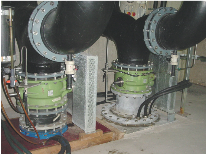
Figur 4: Kühlwasserfassung der KVA Turgi (Quelle: Schnyder Ingenieure AG, Hünenberg)
