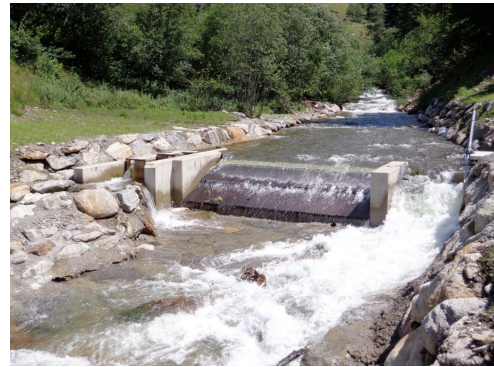
Abbildung 2-5 Tirolerwehr mit Fischaufstieg (rechtsufrig) und Spülschütz (linksufrig), [6]
