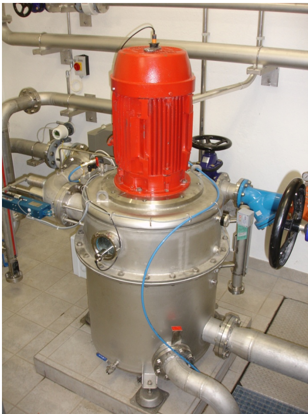
Abbildung 2-24 KWK-Zentrale Fällenden (CH) mit einer Pelton-Gegendruckturbine (17 kW) [21]
