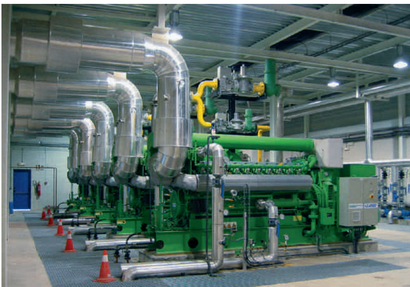
Abb. 3 Mit einer Faulgasmenge von z.B. 1,0 Mio. m 3 können Blockheizkraftwerke über die KEV-Vergütungsdauer von 20 Jahren Einnahmen von rund 7,2 Millionen Franken erzielen. (Foto: Ecoparc Biogas BHKW)
