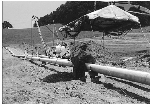
Bild 3.12 Der KKS wurde bis heute vor allem zum Schutz von erdverlegten Leitungen eingesetzt.
