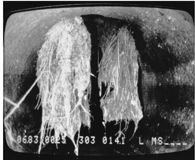
Abb. 3.16 Wurzeleinwüchse erfordern einen erhöhten betrieblichen Unterhalt.
