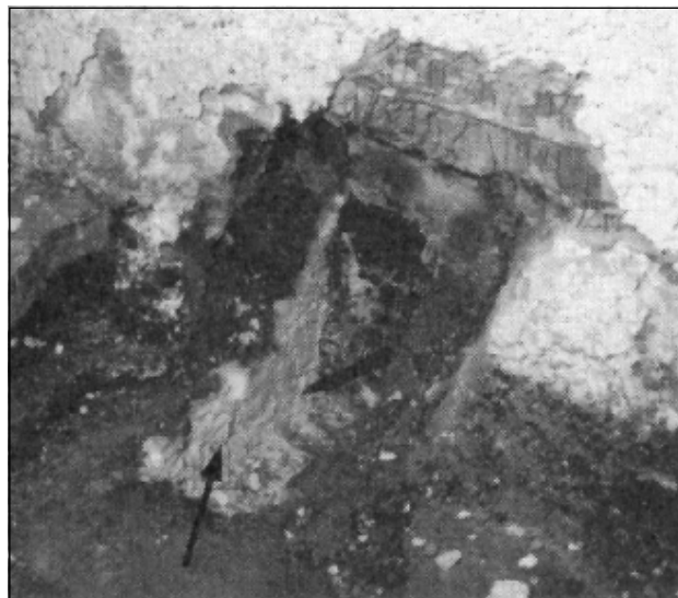
Foto 5.24 0.0 zerstört Bauwerk verlottert, unbrauchbar
