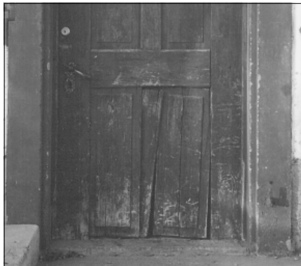
Foto 5.16 0.0 irreparabel Türe ist nicht mehr bedienbar, keine Schutzfunktion mehr
