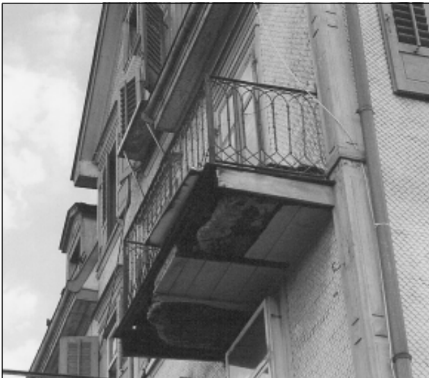
Foto 5.11 0.2 stark schadhaft Tragende Teile korrodiert oder abgewittert, Sicherheit nicht mehr gewährleistet. Vollständige Ablösung des Belages, Geländer korrodiert
