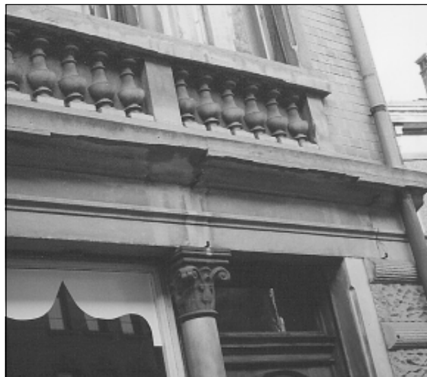
Foto 5.6 0.5 mittel schadhaft Kanten eingebrochen, Teilflächen abgelöst, Profilierungen verwittert, beginnender Materialabtrag
