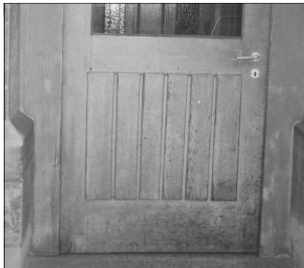
Foto 5.14 0.5 mittel schadhaft Anstriche abgelöst, beginnende Korrosion an Beschlügen Türblatt leicht verzogen, Undichtheiten
