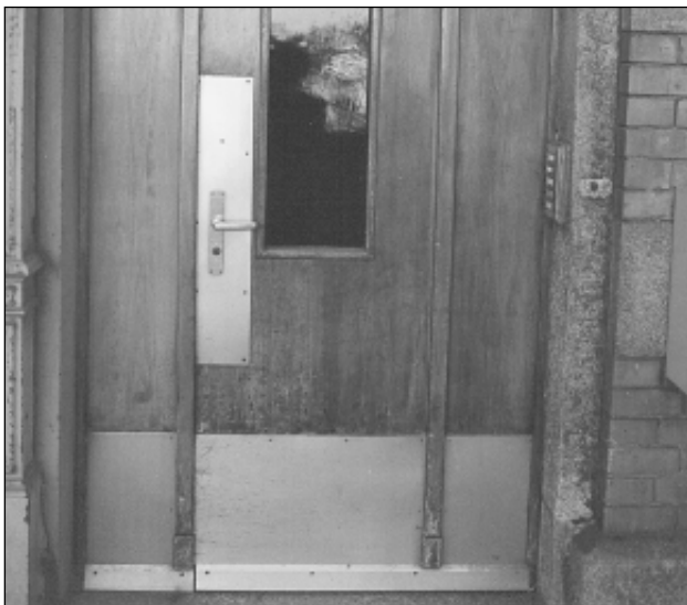
Foto 5.13 0.8 leicht schadhaft Aussenfläche verwittert, Sockelbleche angerostet geringe Undichtheit
