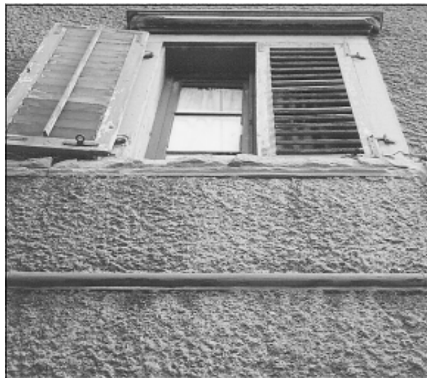
Foto 5.8 0.0 zerstört Werkstücke herausgefallen, lose Teile; Flächen vollständig ausgewaschen
