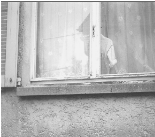
Foto 5.5 0.8 leicht schadhaft Kanten verwittert, Fugen ausgewaschen, kleine Risse
