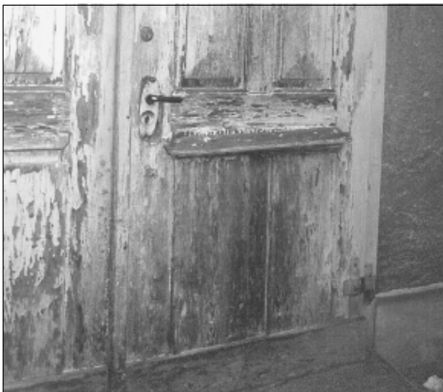
Foto 5.15 0.2 stark schadhaft Holzteile angefault, Metall korrodiert Beschlüge defekt, Schliessung unbrauchbar
