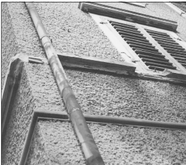
Foto 5.7 0.2 stark schadhaft Durchgehende Risse, Teile abgefallen, Teile verschoben, offene Fugen, fortgeschrittener Materialabtrag durch atmosphärische Einwirkungen
