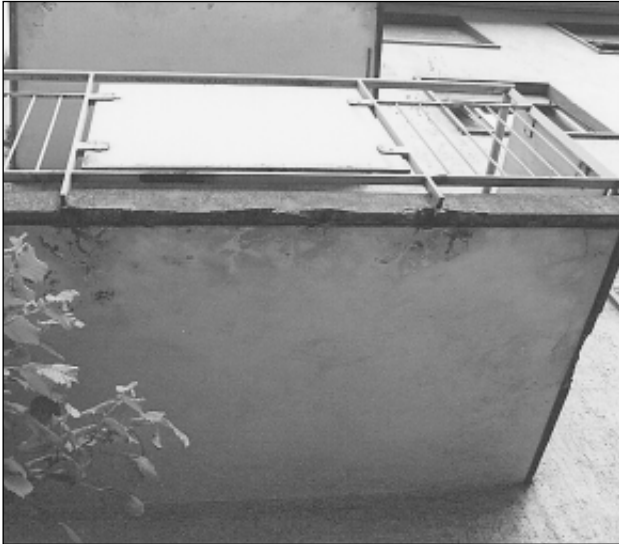
Foto 5.9 0.8 leicht schadhaft Feine, stabilisierte Risse in Platte und Überzug kleinere Kantenschäden, leichte Korrosionen an Geländern
