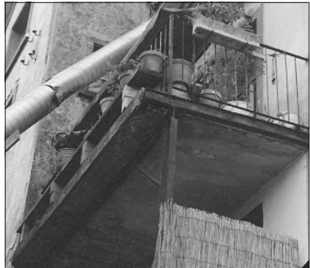
Foto 5.12 0.0 irreparabel Platten und Träger geborsten; für die Benützung gesperrt
