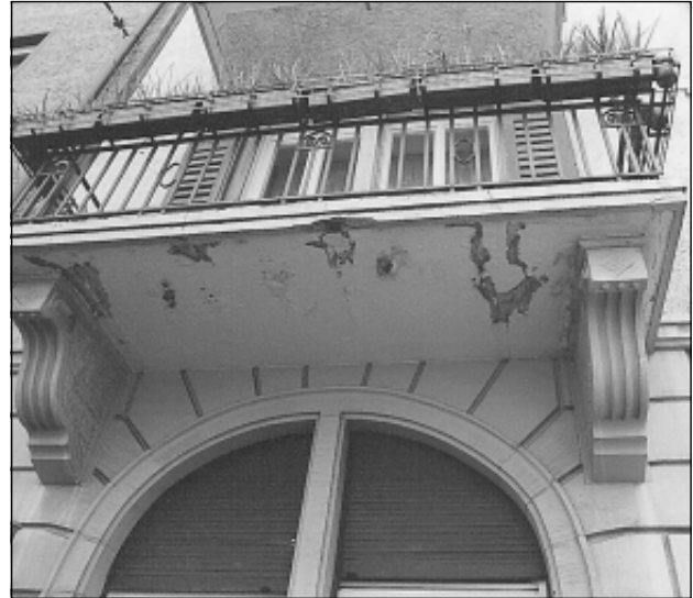
Foto 5.10 0.5 mittel schadhaft Risse und Abplatzungen ohne Gefährdung der Sicherheit Ablösungen im Belag Kanten beschädigt, eindringendes Wasser
