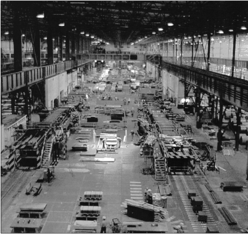
Bild 3.4: Halle mit neuer Beleuchtungsanlage (Quelle: /28/)
