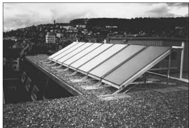
Finanziell ein Erfolg: die Solaranlage auf dem Dach des Hotelplan-Hauptsitzes in Zürich.
