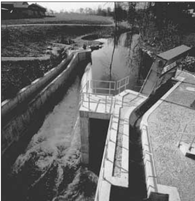
Wasserfassung. Von links: Fischpass, Wehr, Rechenreinigungsmaschine, Geschwemmselrinne
