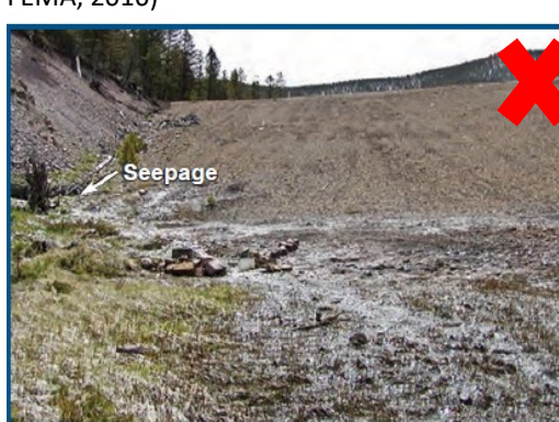
Durchsickerungen entlang der Wiederlager des Dammes (Bild: FEMA, 2016)
