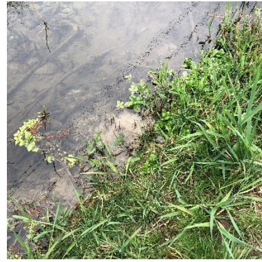
Austritte von Feinmaterial in luftseitigen Sickerwasserkanal (Bild: BFE Aufsichtstätigkeit)
