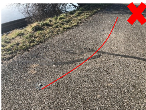
Setzungsmulden in der Dammkrone deutet auf schwaches oder erosionsanfälliges Material im Damm oder der Foundation hin (Bild: BFE Aufsichtstätigkeit).
