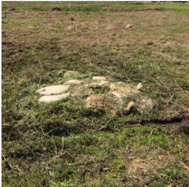
Austritte von Feinmaterial im luftseitigen Vorfeld des Dammes (Sandboils)
