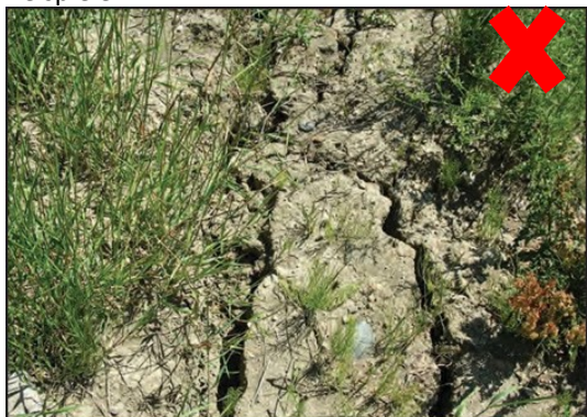
Transversal Risse im Damm deuten auf Setzungen hin (Bild: FEMA, 2016).
