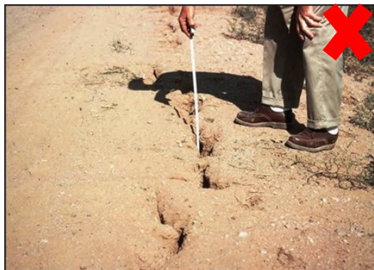
Längsrisse deuten auf Setzungen oder Instabilitäten im Damm hin (Bild: FEMA, 2016).
